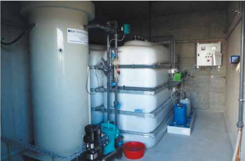
▲ Equipements de prétraitement biologique des eaux usées
